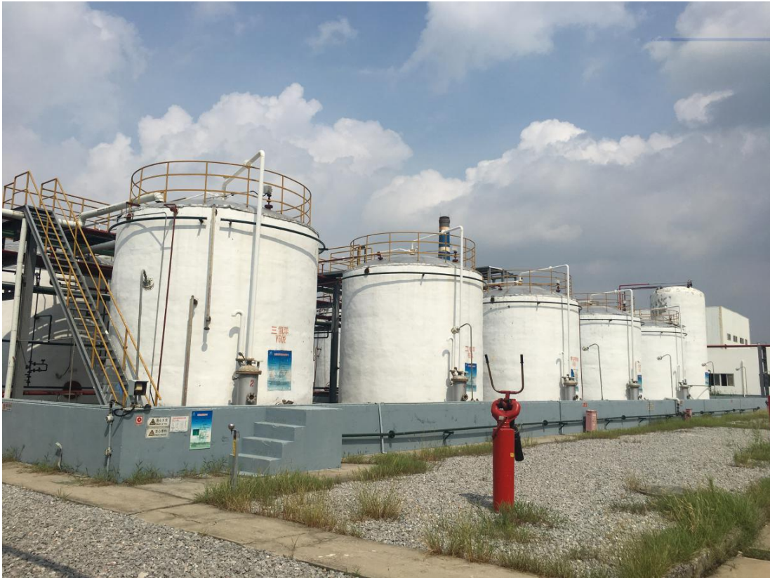
图 4-37 企业罐区现场图片
