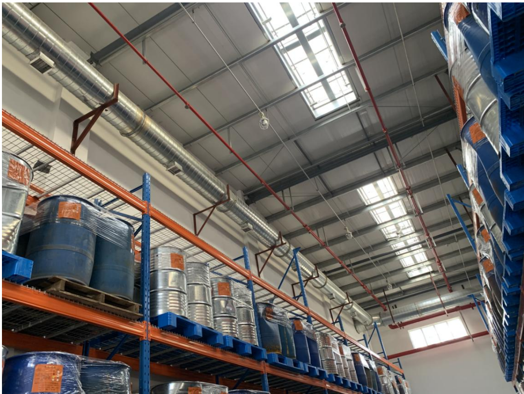
图 4-32 项目危废仓库照明设施及分类堆放图
