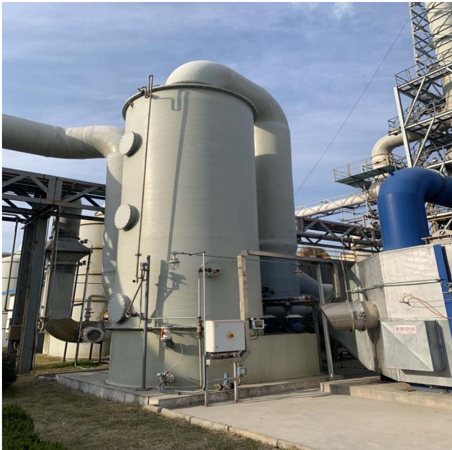
图 4-8 碱喷淋装置（4#RTO 配套）现场图
