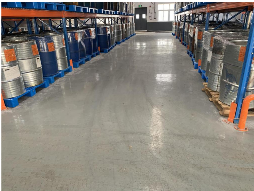
图 4-23 项目危废仓库环氧树脂地面
