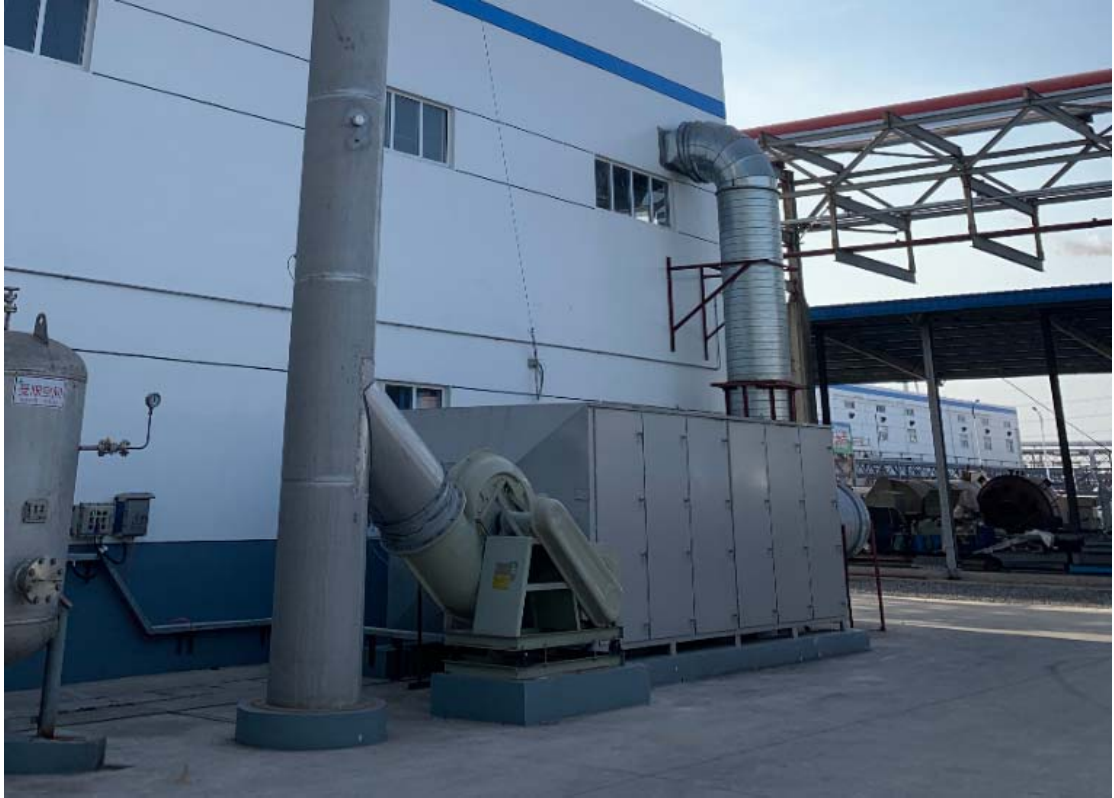
图 4-9 活性炭吸附装置（危废仓库配套）现场图
