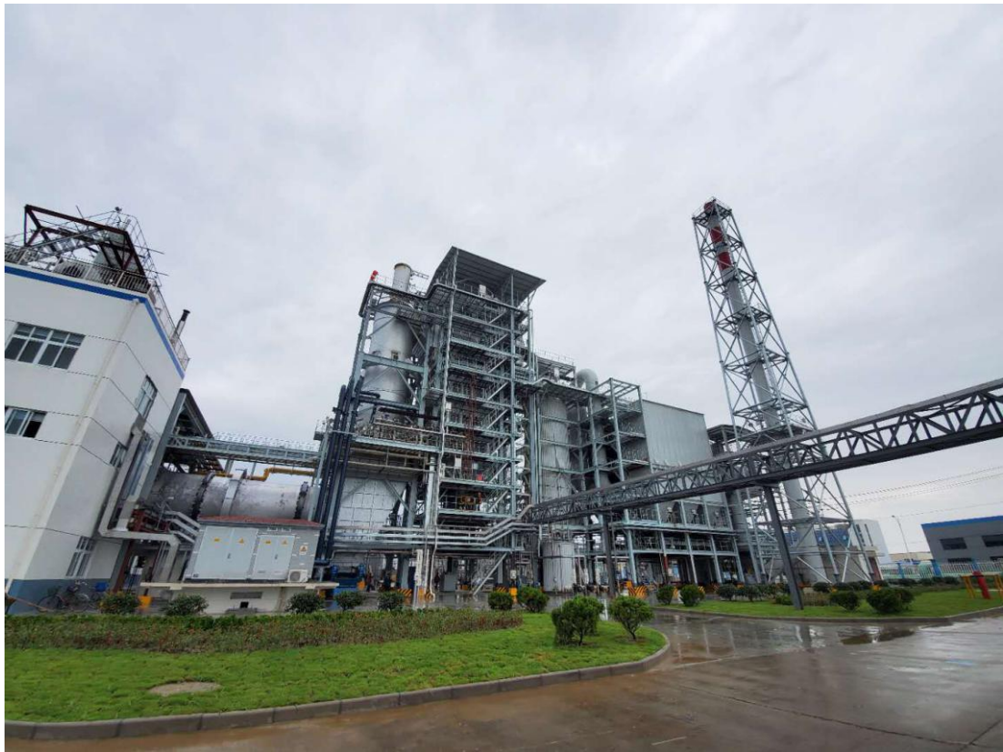
图 4-10 危废焚烧炉现场图
