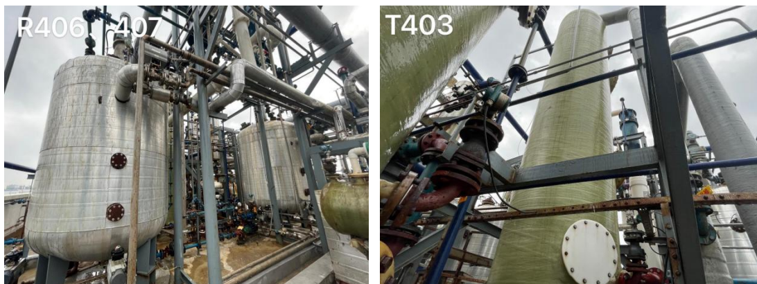
图 4-3 三级碱液吸收装置现场图
