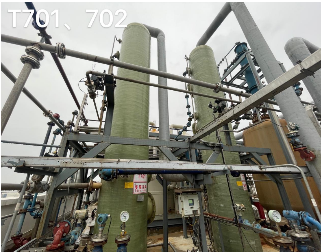
图 4-6 一级水+一级碱吸收处理装置现场图
