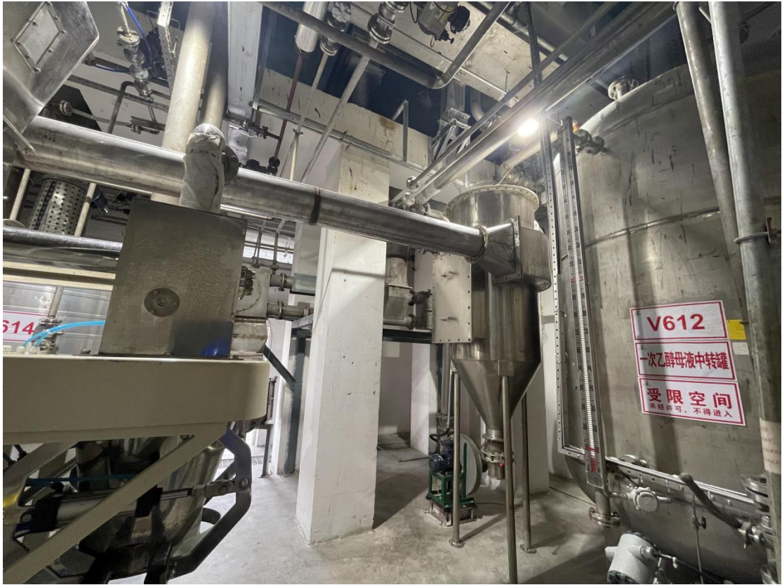
图 4-5 布袋除尘装置现场图
