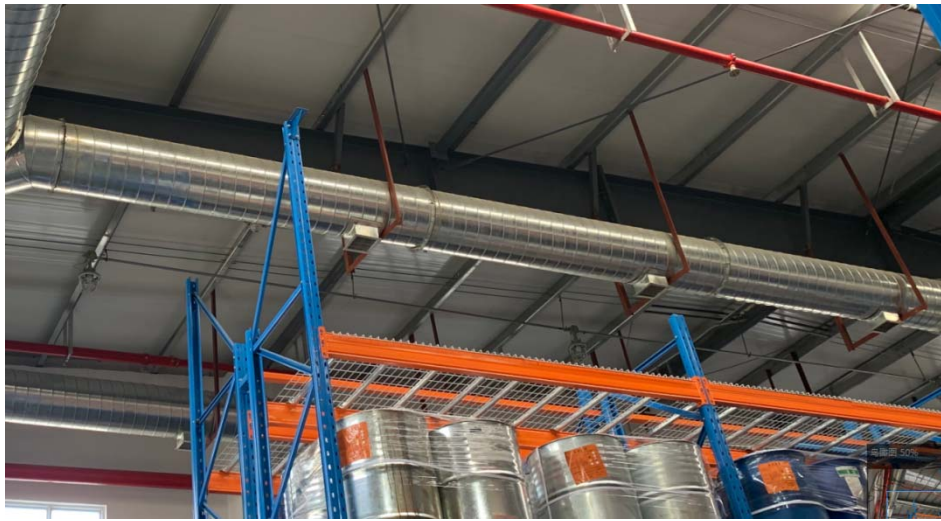
图 4-29 项目危废仓库内废气收集装置图
