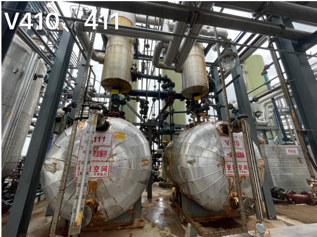
图 4-2 二级降膜吸收装置现场图
