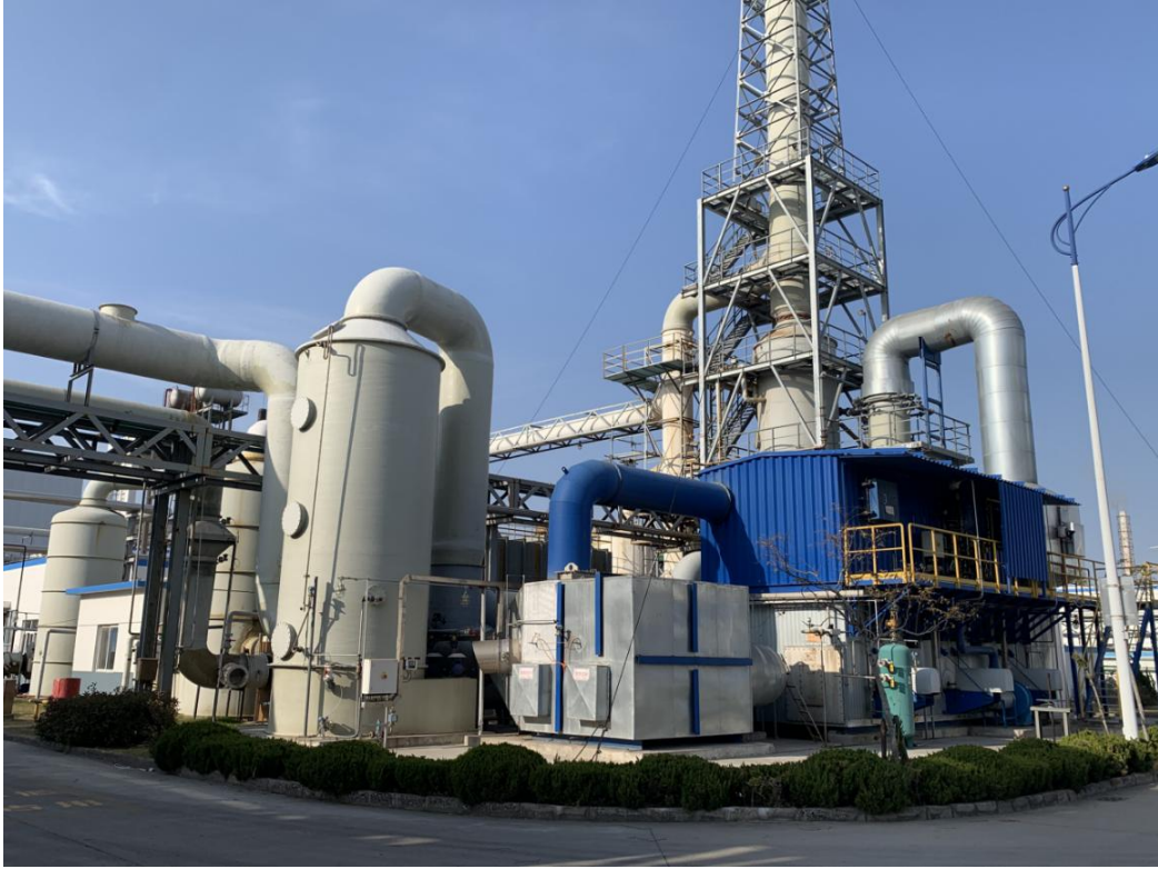
图 4-7 4#RTO 焚烧炉现场图
