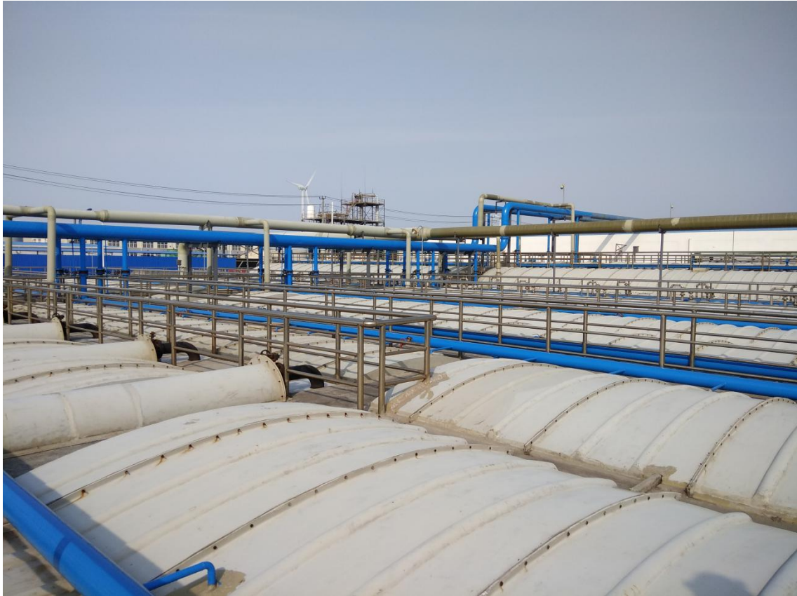
图 4-13 2000 吨/日综合废水处理设施现场图片
