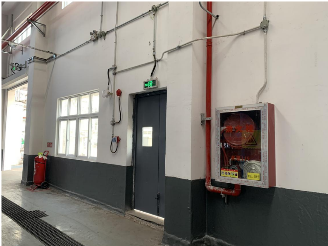
图 4-27 项目危废仓库照明设施
