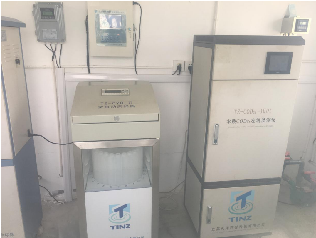
图 4-39 废水在线监测装置现场图片
